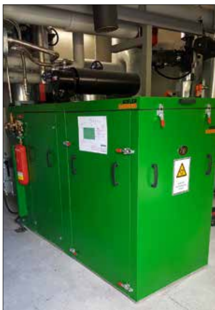
Zusätzliches Blockheizkraftwerk mit 50 kW.
