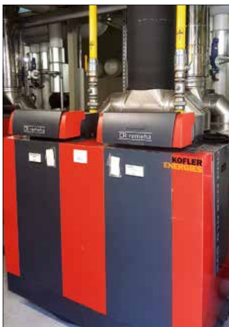
Zwei von sechs Kesseln à 574 kW im Heizhaus des Stadions.
