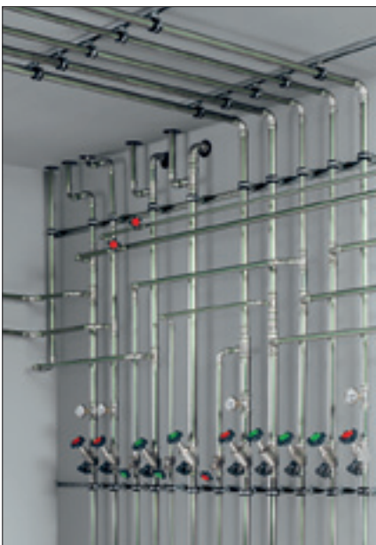
Trinkwasserinstallation mit Viega Sanpress Inox
