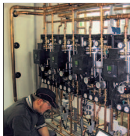
Kaskade mit Oventrop Frischwasserstationen
